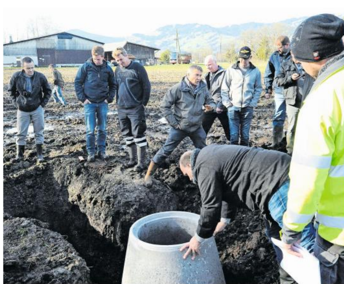
Aufschlussreich: Ein Blick in den Schacht einer Drainage-Sammelleitung, die von der Melioration kürzlich bei Norbert Schicks Siedlung Wegweiser im Isenriet bei Marbach neu verlegt wurde. Bild: Max Tinner
